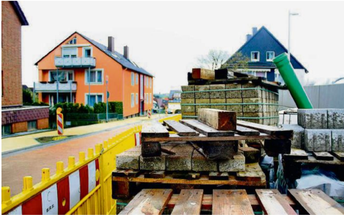
Die Geschehnisse während der Bauarbeiten an der Kampstraße in Bad Nenndorf haben bei Beobachtern für Kopfschütteln gesorgt. FOTO: ARCHIV
